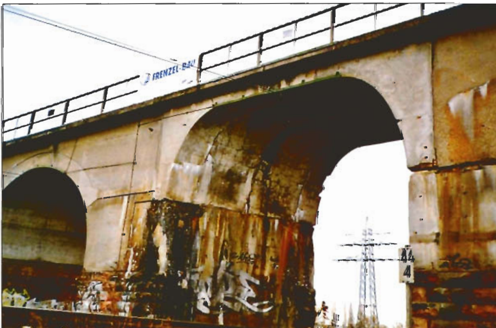
Abb. 11: Schadhafte Betonbögen der Brücke
